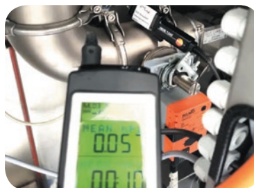
Контроль перепада давления на финишном фильтре депирогенизационного туннеля
